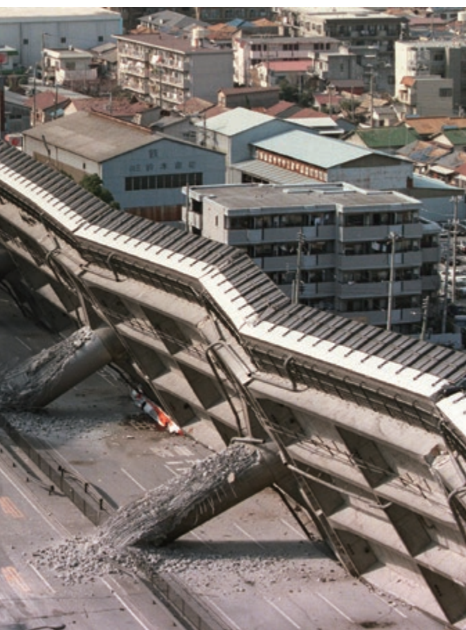
3号神戸線は物流機能の生命線であり、その倒壊は大きな衝撃を与えた
